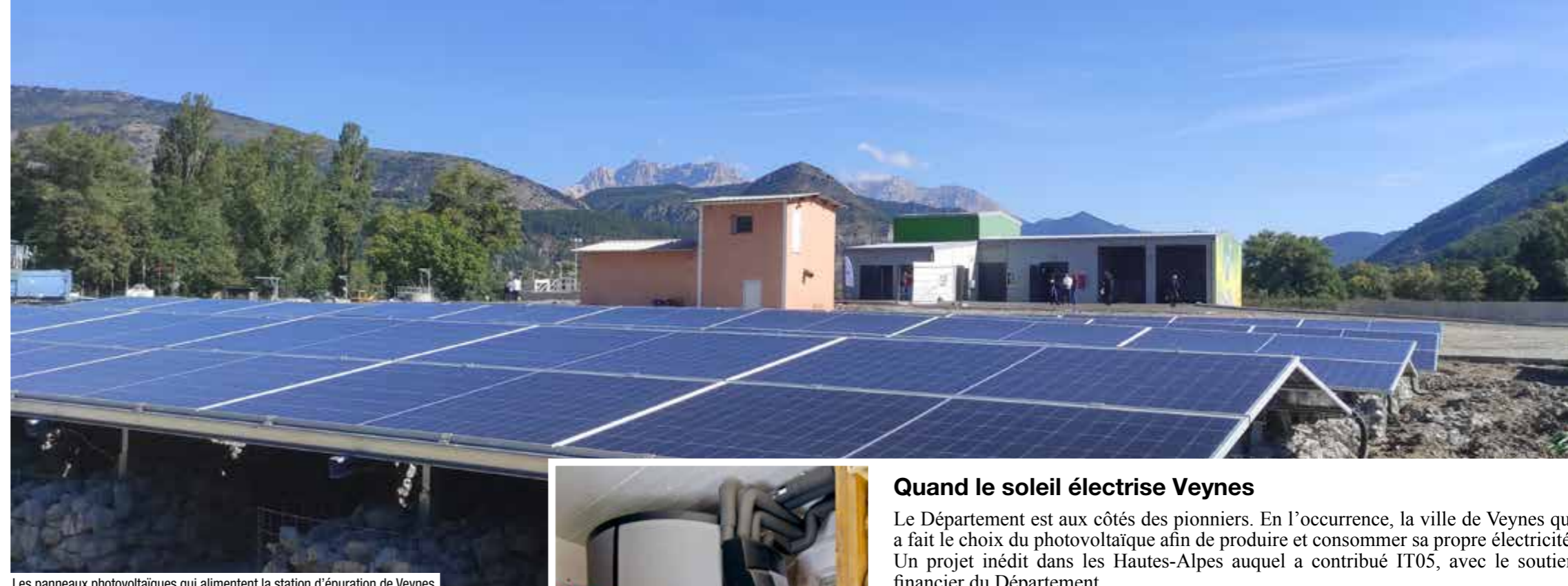
Les panneaux photovoltaïques qui alimentent la station d'épuration de Veynes
