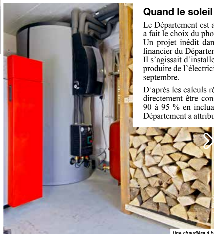
Une chaudière à bois
