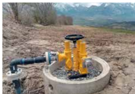
Nouvelle borne d'irrigation du réseau de l'Asa du Rocher Roux (Saint-Bonnet-en-C.)
