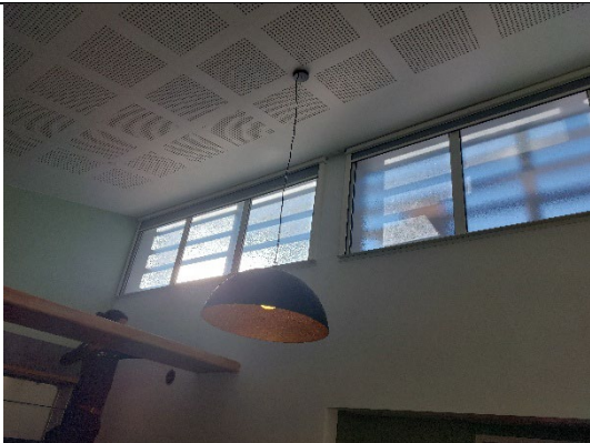
Stores électriques supérieurs
