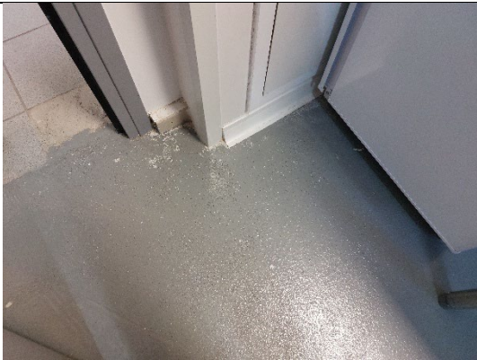
Résine au sol avec traces d'enduit
