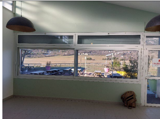
Stores électriques inférieurs
